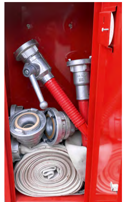
Bild 8 / Lagerschrank für Löschequipment. Nicht zu sehen sind die Materialien zur Entnahme aus dem Hydranten wie Standrohr und Unterflurhydrantenschlüssel.
